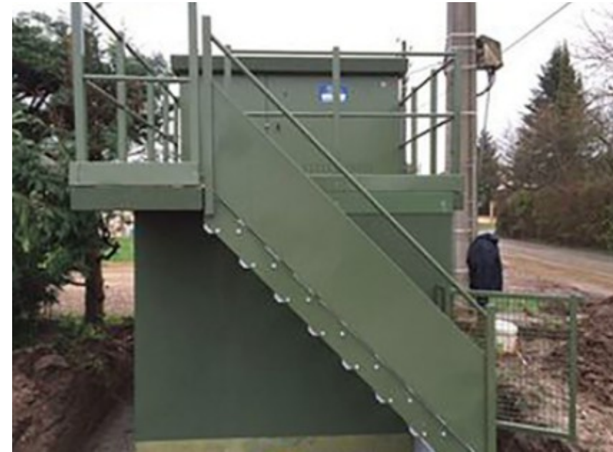
Illustration 77: Exemple de poste de transformation et de livraison HTA/BT réhaussé (rehausse pssa, s.d.)
